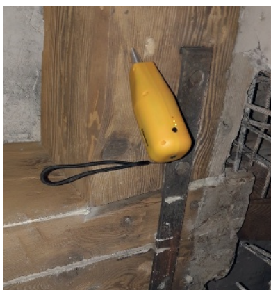
Relevés de mesures avec le Sylvatest dans le cadre de l'évaluation des structures des entrepôts des magasins généraux de Paris, désormais transformés en hôtel Hilton. Photo : CBS
