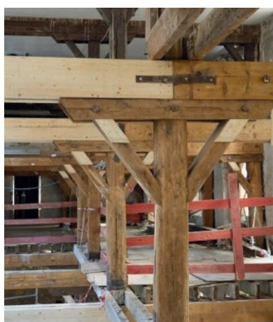
10 % environ de bois des structures des entrepôts des magasins généraux ont été renforcés. Le reste a pu rester en place, tout en recevant des charges supérieures. Photo : CBS
