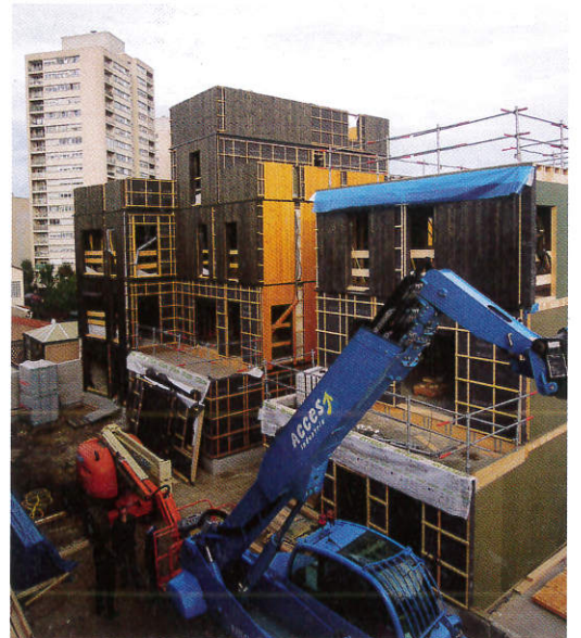
Le chantier rue Dolet. Les façades sont amincies pour empiéter au minimum sur la surface de plancher.
